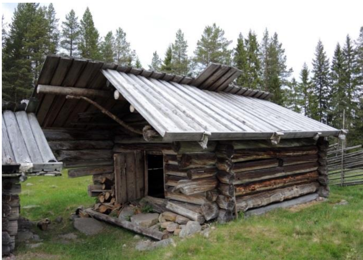
Eldhus, byggnad nr 1, bräddtak med vankanter.
