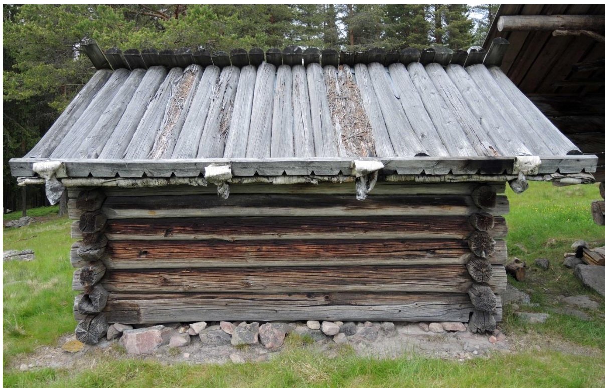
Byte av uttjänt takved behöver göras med jämna mellanrum, som här på en av mjölkbodarna, byggnad nr 2. Upptäckt skada noteras i besiktningsprotokollet, förs in i åtgärdsplanen. Byte av takved är en enklare typ av åtgärd och kan utföras av lekmannen i samband med det årliga underhållet. Åtgärden begränsas till just de rötskadade klovorna, här handlar det om tre till fem stycken.
