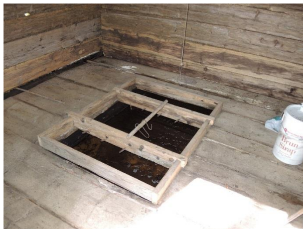
Kylhusens golv ligger lågt över ymniga vattenflöden. De är hårt utsatta för väta. Är golven säkra att beträda?
